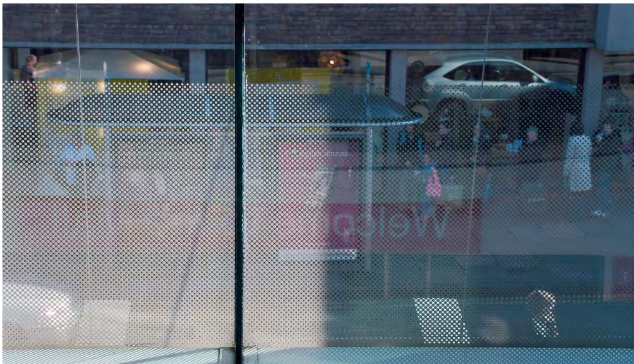
Selon l'éclairage, les marquages sur les vitres ont un effet très différent. Cette vitrine est entièrement couverte d'une trame pointillée assez dense. Dans la partie qui n'est pas directement éclairée par le soleil, un certain nombre de choses sont visibles. L'image sur la gauche apparaît beaucoup plus diffuse. Pour une protection efficace contre les collisions, une trame un peu moins serrée serait d'ailleurs encore suffisante.
